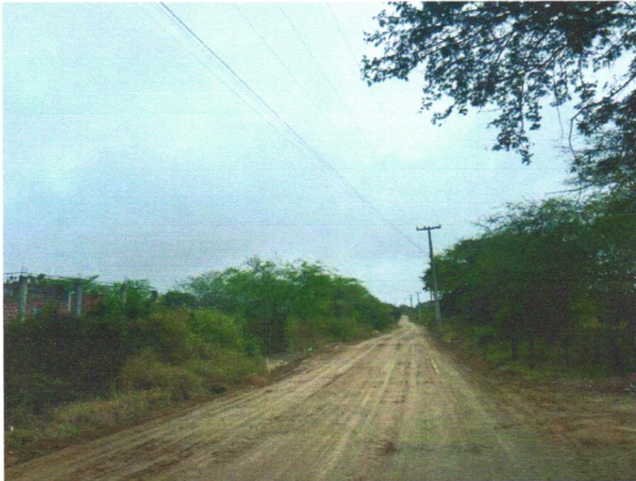
FOTO 05 - EXECUÇÃO E COMPACTAÇÃO DE BASE E OU SUB BASE PARA PAVIMENTAÇÃO DE SOLO ESTABILIZADO GRANULOMETRICAMENTE SEM MISTURA DE SOLOS - EXCLUSIVE SOLO, ESCAVAÇÃO, CARGA E TRANSPORTE. AF_11/2023
